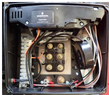
Figure 2 : Vue intérieure du boîtier électrique
